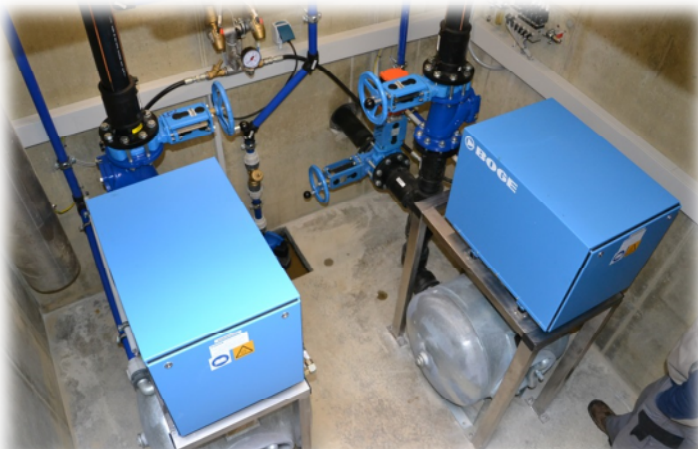
Blick in das Pumpwerk mit den beiden Kompressoren und der Schaltwarte
